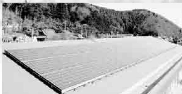
▲屋根に設置された太陽電池
