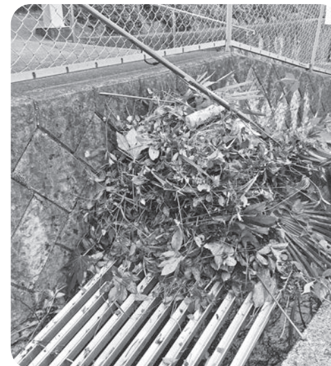
本町除じん機の様子
