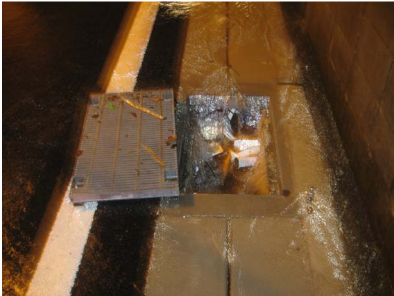
ゴミによって詰まった側溝
