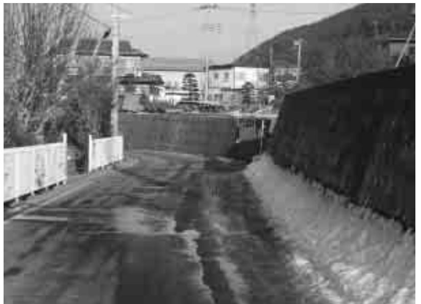
倉見地内の道路降雪・凍結状況
