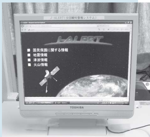
防災無線室に設置されたJアラートシステム
