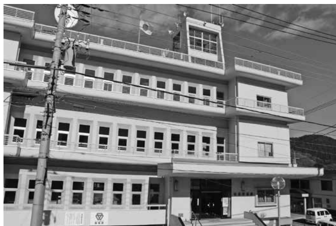
老朽化により建て替えが望まれる役場庁舎
