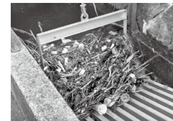
◀町内に設置されている除塵機にごみが溜まった様子
