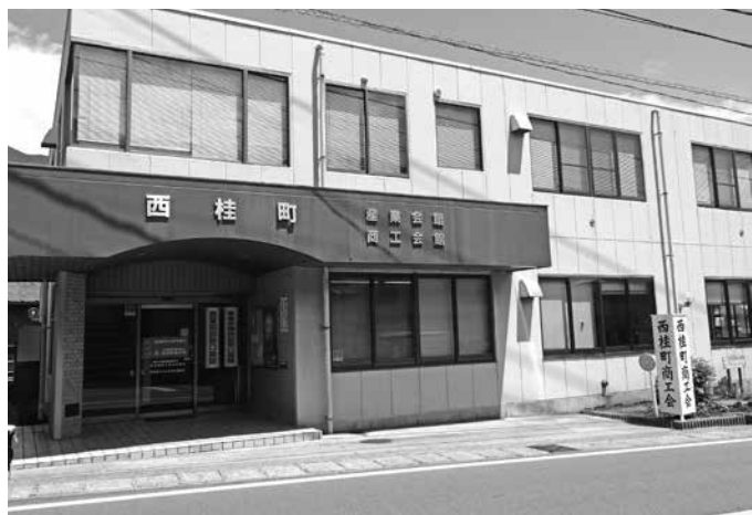
老朽化が進む産業会館・商工会館
